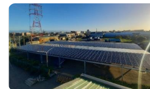
企業儲能設備
